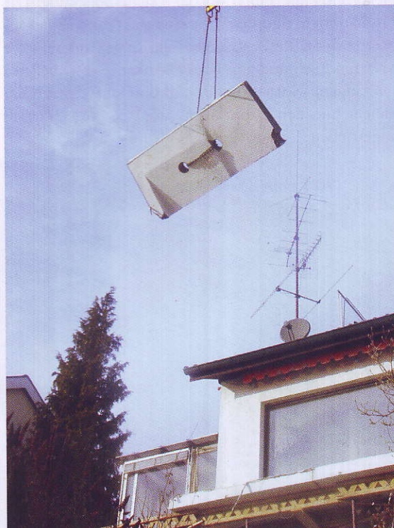
Balkonsanierung mit fliegendem Wechsel: Die alte Balkonplatte hatte aus energetischer Sicht die Funktion einer Kältebrücke
